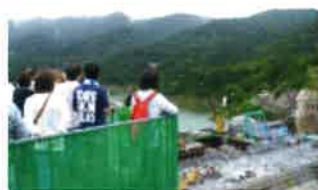
工事の状況が大迫力で見学できる展望所スペース(一般開放は11月上旬まで)
