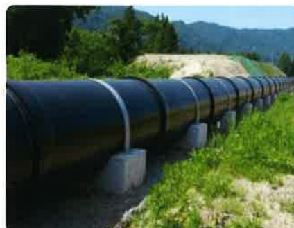
清水バイパス(設置状況)
